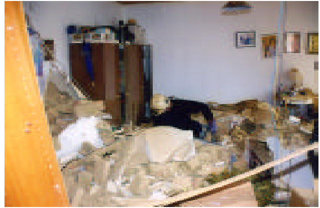
Gasexplosionen schaffen Unordnung
