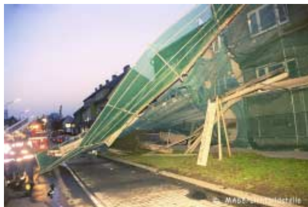
Unordnung nach Gerüsteinsturz
